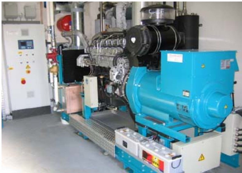
Слика 1. Комбинована производња топлотне и електричне енергије од биогаза у СНР постројењу
